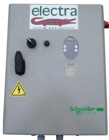
Coffret électrique avec variateur de fréquence
